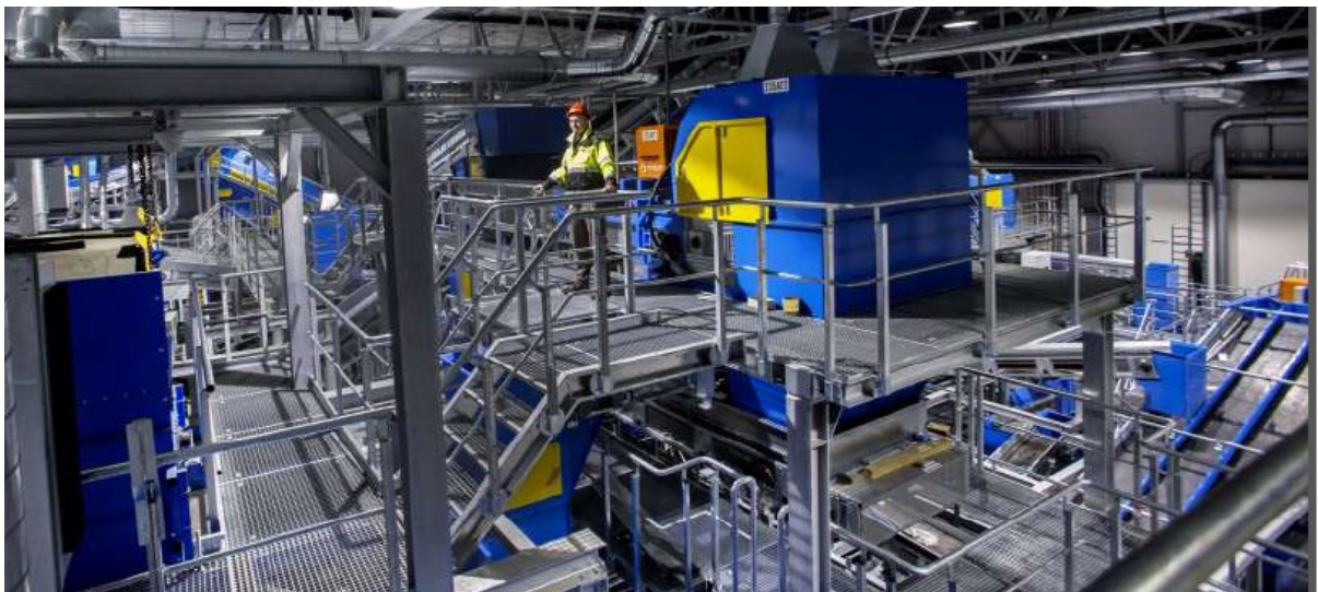
Bilde frå Romerike Avfallsforedling IKS (ROAF) sitt ettersorteringsanlegg. Foto: Mepex Consult
